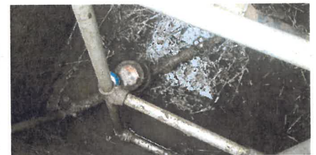
Immer wieder kommt es bei länger unentdeckten Wasserrohrbrüchen im Eigenheim zu massiven Wasserverlusten.
